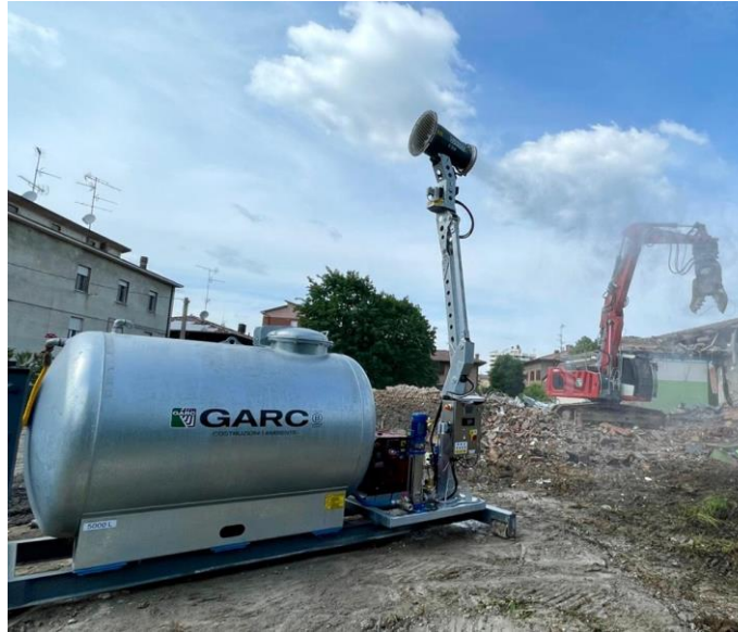
Stazione di abbattimento polveri
